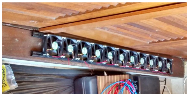
Figura 6.2 – Banco de ventiladores.
