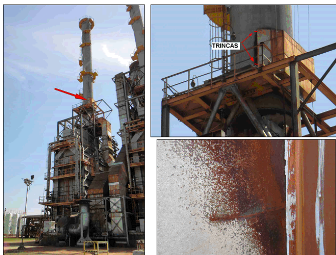
Figura 1.2 – Trincas observadas na chaminé do forno B.
