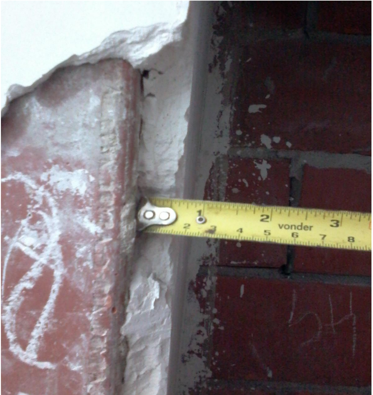
Figura 27 – Espessura elevada do revestimento de pasta de gesso no empreendimento PM
