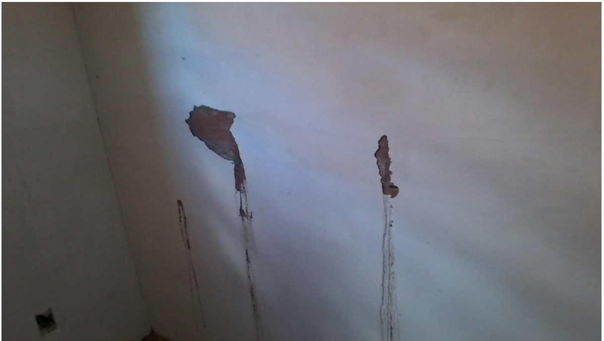
Figura 30 –Desplacimento do revestimento de pasta de gesso
