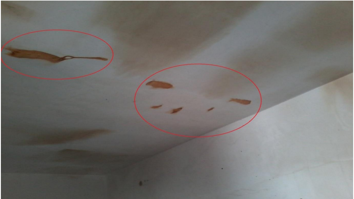
Figura 8 – Pontos de oxidação no revestimento de pasta de gesso
