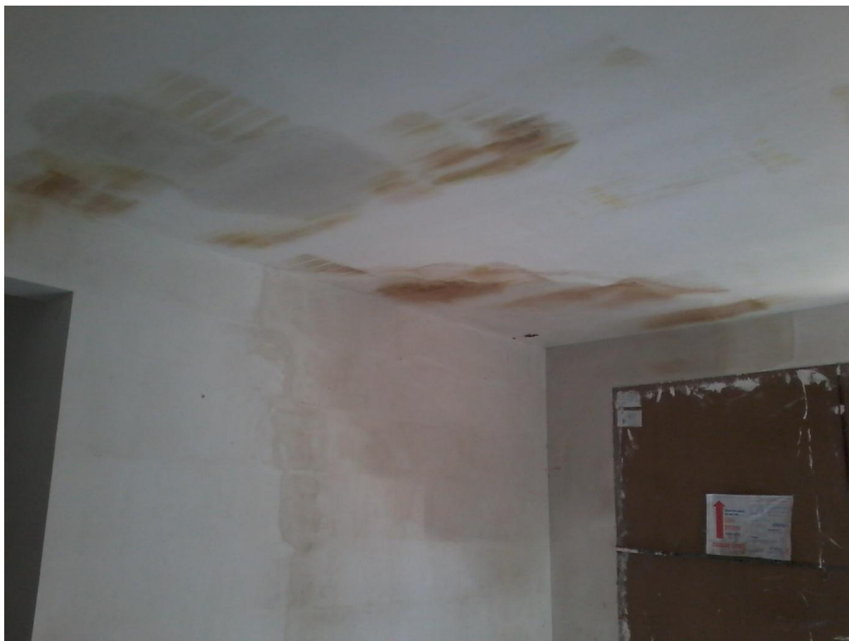
Figura 21 – Amarelamento do revestimento de pasta de gesso no empreendimento PM
