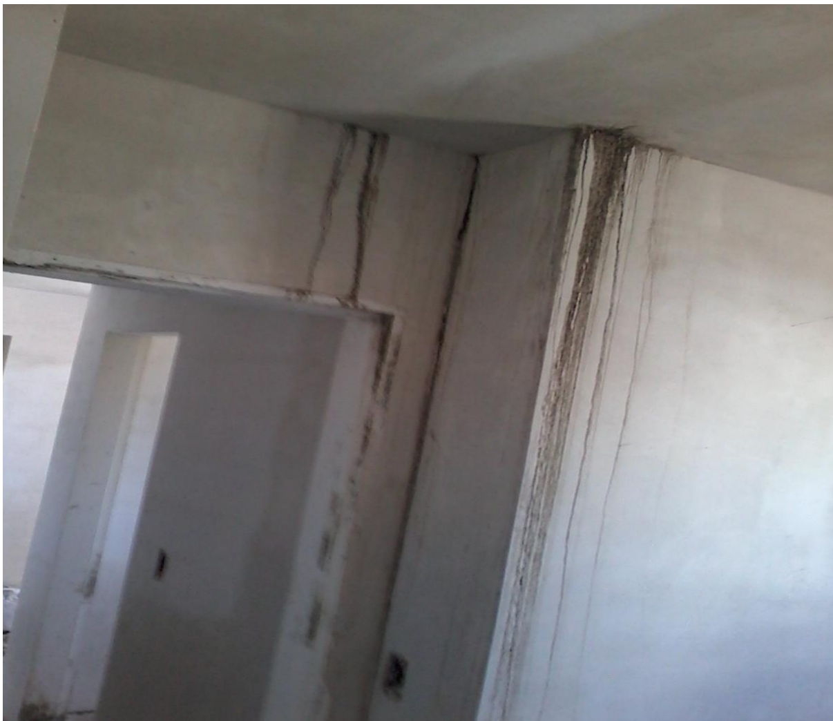
Figura 23 – Percolação de água nas paredes e tetos
