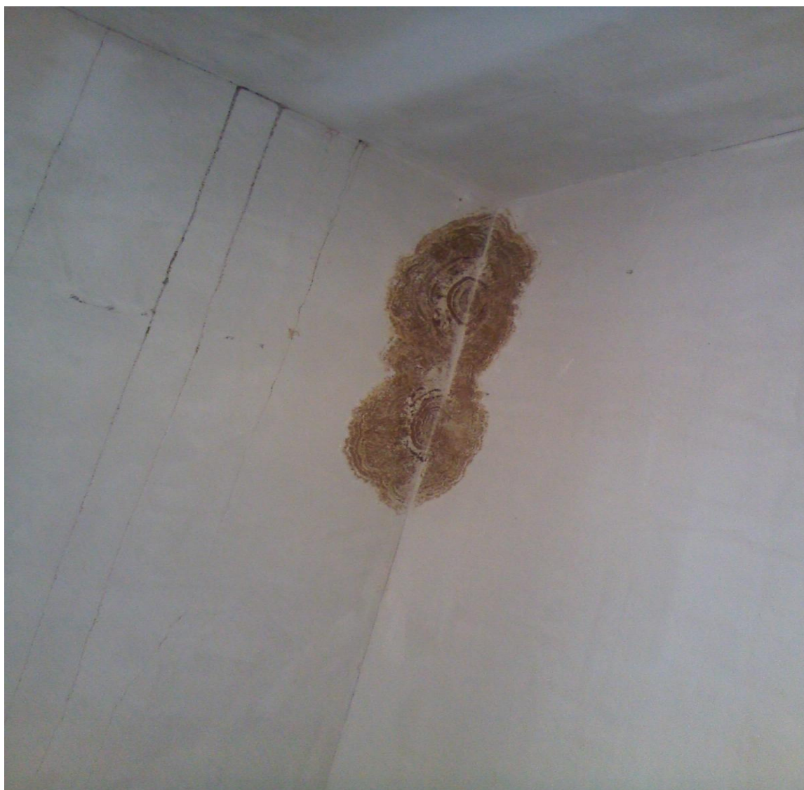
Figura 7 – Manifestação de fungos no revestimento de pasta de gesso
