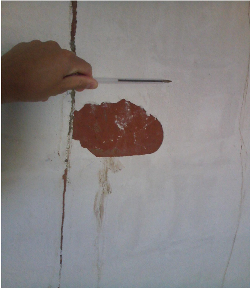
Figura 6 – Deslocamentos ocorridos no revestimento de pasta de gesso
