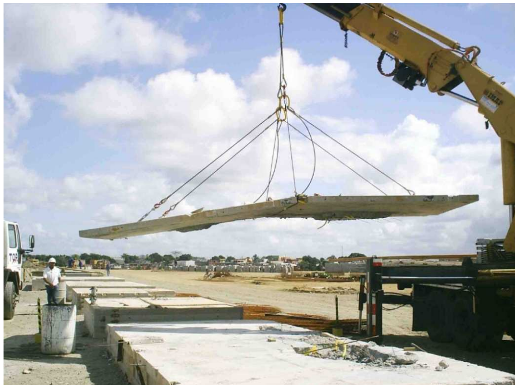
Figura20 – Parede de concreto pré-fabricada inutilizável devido ao transporte
