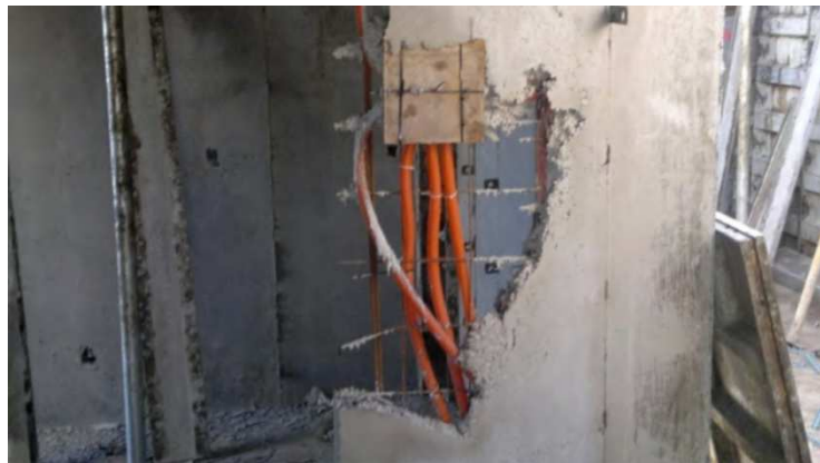
Figura25 – Reprovação no serviço de concretagem
