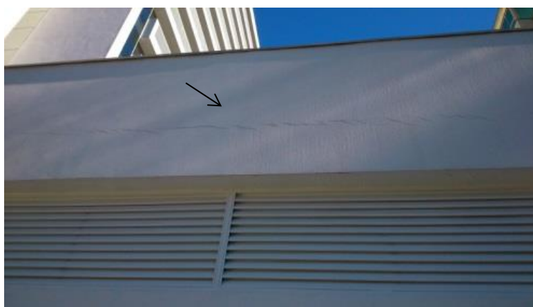
Figura 12 – Fissuras no encontro de viga e alvenaria
