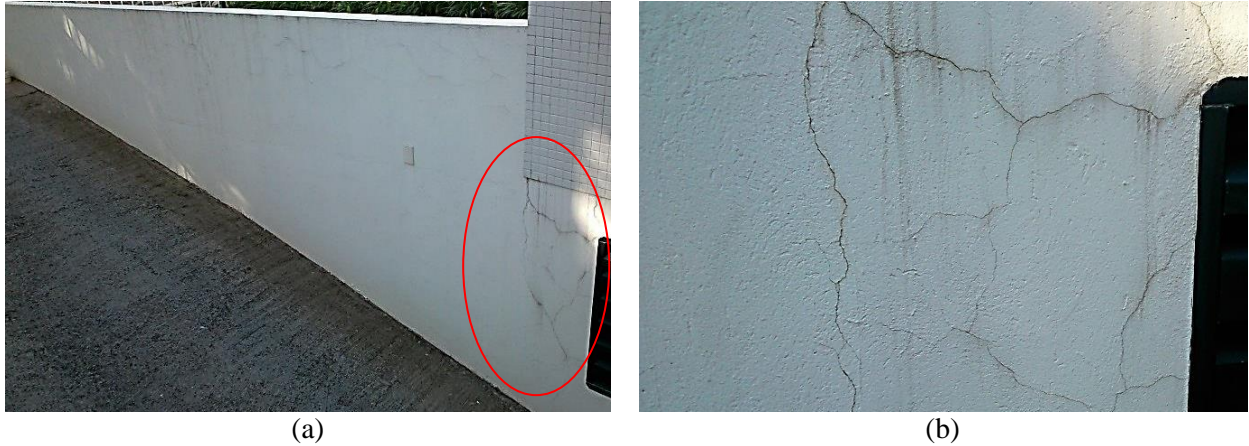
Figura 40 – (a) estrutura de contenção com presença de fissuras e (b) formato de dispersão das fissuras situadas na estrutura de contenção
