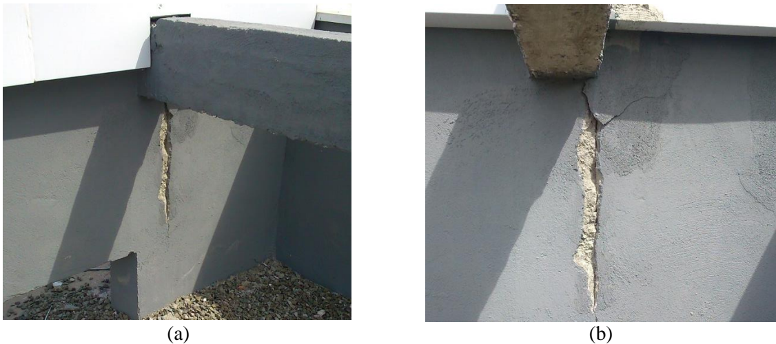
Figura 24 – (a) disposição de fissura entre pilarete e alvenaria e (b) vista de outro ângulo da fissura
