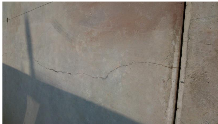
Figura 10 – Lajes de estacionamento com juntas mal executadas, apresentando sintomas de fissuramento
