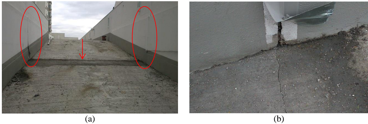
Figura 16 – (a) fissura na rampa de acesso ao estacionamento e (b) detalhe que evidencia fissura na rampa e muro
