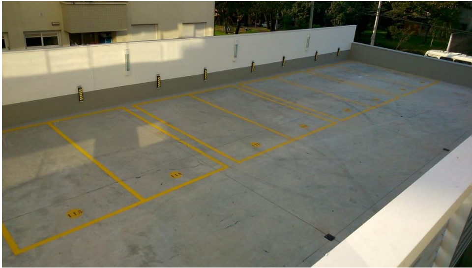
Figura 9 – Lajes de estacionamento com juntas horizontais e verticais
