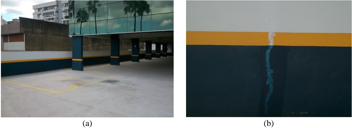
Figura 23 – (a) vista do muro do estacionamento descoberto e (b) fissura transversal com tentativa de reparo
