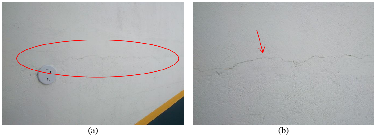
Figura 26 – (a) visão geral do muro contendo a fissura e (b) visão em aumento exibindo a fissura permeada no muro
