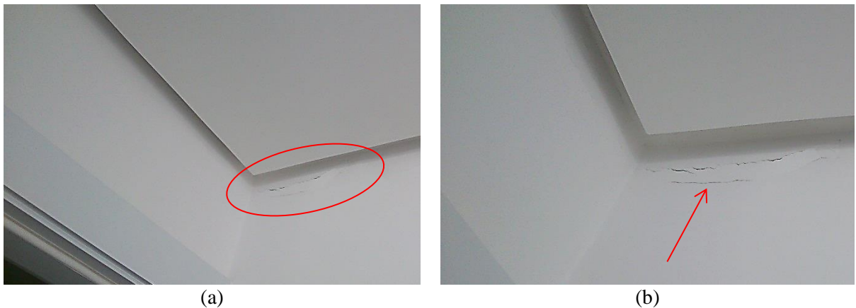
Figura 36 – (a) fissura entre viga e alvenaria e (b) visão em aumento exibindo fissura
