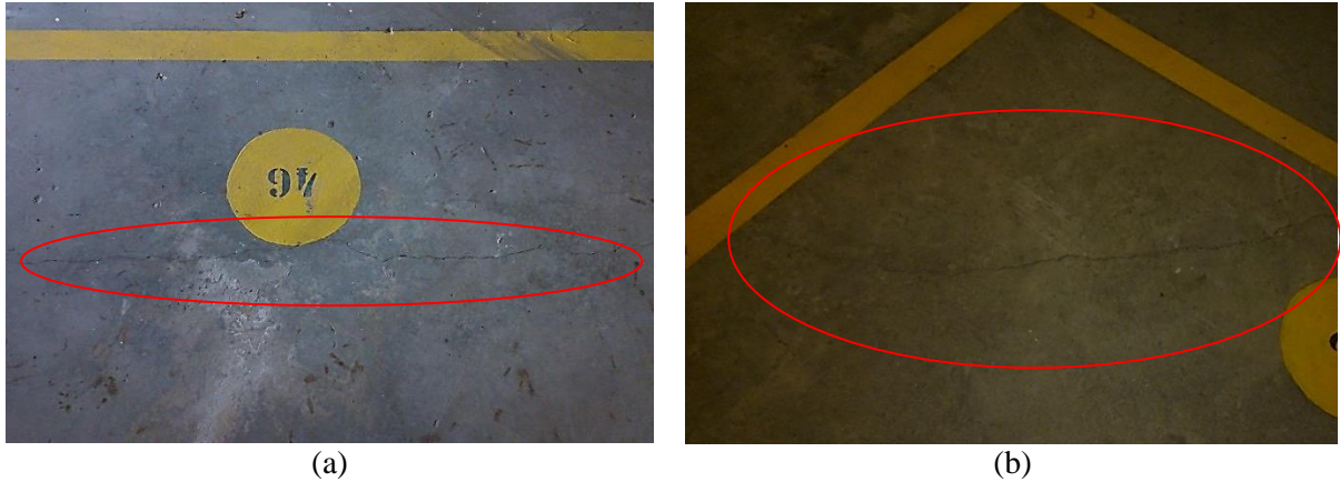
Figura 33 – (a) fissura localizada no contrapiso do estacionamento e (b) fissura localizada no contrapiso do estacionamento
