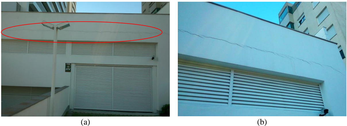
Figura 19 – (a) fachada do acesso ao estacionamento descoberto e (b) visão aumentada evidenciando a fissura da fachada
