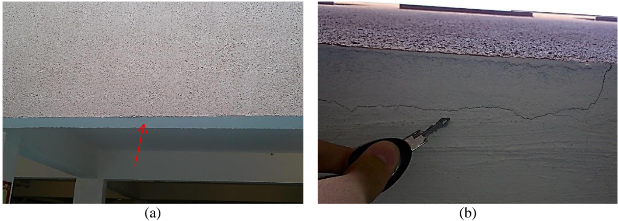
Figura 35 – (a) vista frontal da fissura localizada abaixo da viga da fachada e (b) vista inferior da viga fissurada
