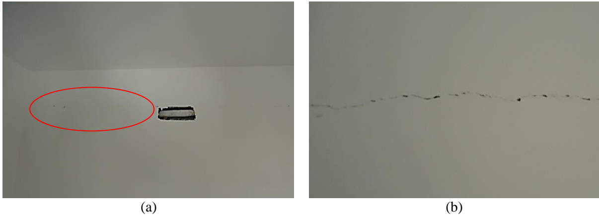
Figura 37 – (a) Parede do dormitório com presença de fissura e (b) aproximação da fissura localizada no dormitório
