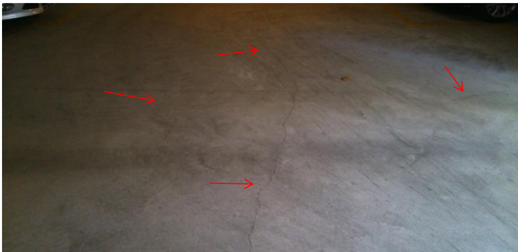
Figura 41 – Contrapiso do estacionamento com presença de fissuras
