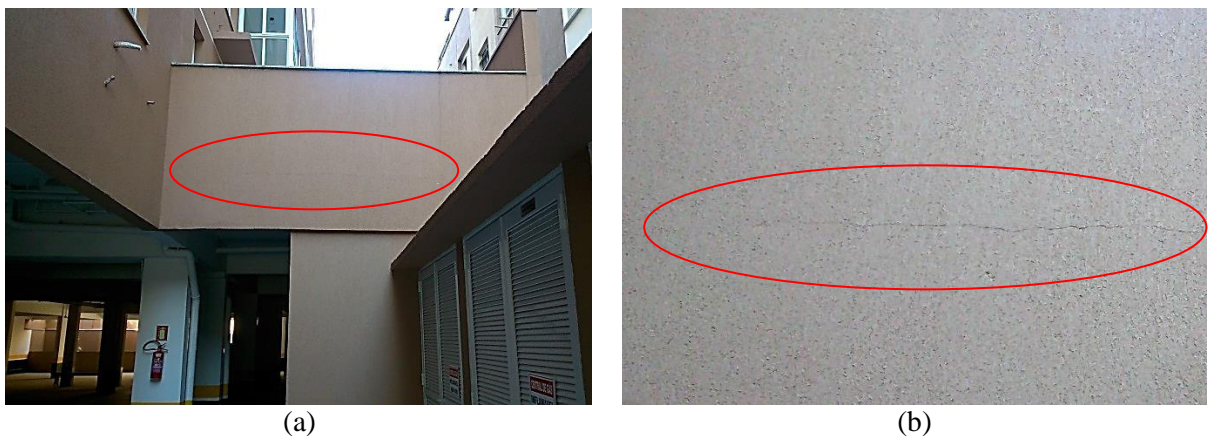
Figura 32 – (a) panorama da fissura situada na platibanda do terraço e (b) ampliação da fissura situada na platibanda do terraço
