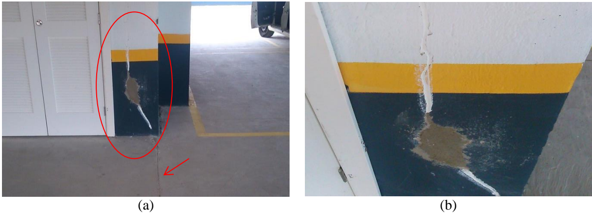
Figura 27 – (a) situação do local de abrangência da fissura e (b) vista aproximada da disposição da fissura
