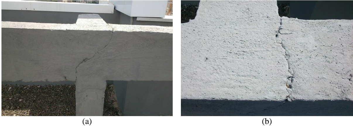
Figura 25 – (a) vista lateral da fissura e (b) vista superior da fissura
