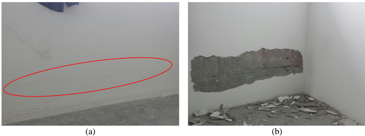
Figura 17 – (a) fissura longitudinal em toda extensão da parede e (b) início do processo de reparo da fissura
