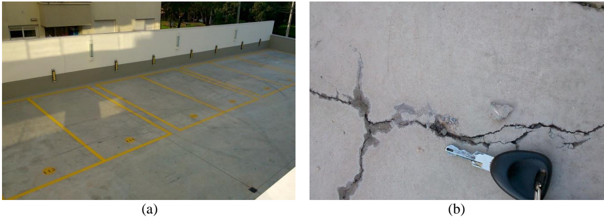
Figura 18 – (a) visão panorâmica da área de distribuição das fissuras e (b) aspecto da fissura em comparação proporcional a uma chave
