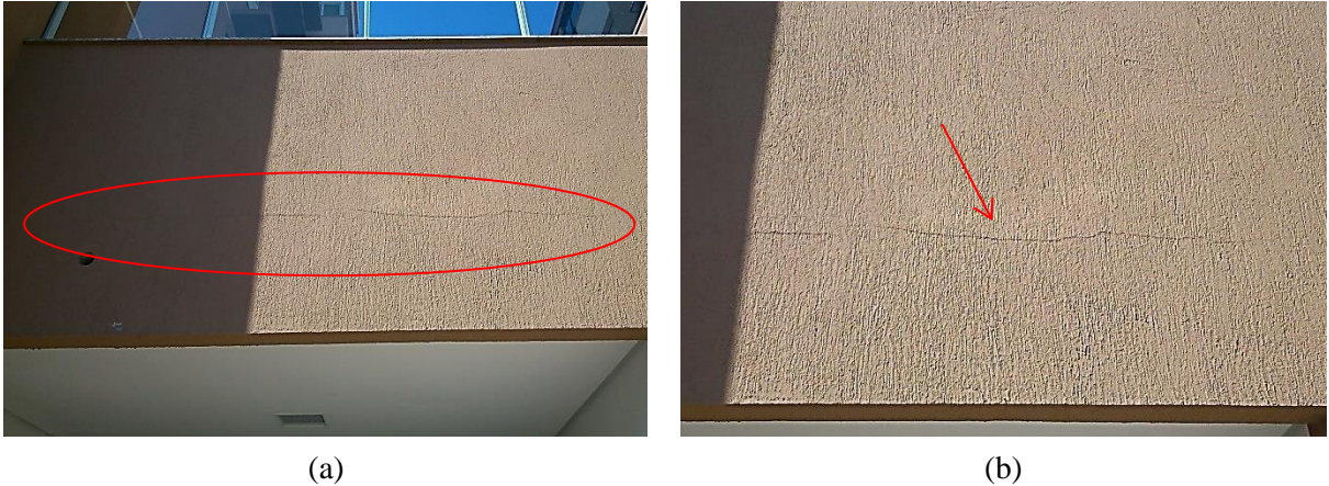
Figura 31 – (a) ocorrência da fissura no muro do estacionamento e (b) visão ampliada da fissura observada no muro do estacionamento
