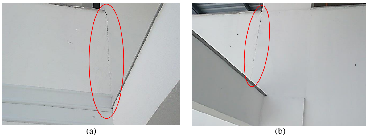
Figura 30 – (a) fissura entre alvenaria e pilar e (b) fissura entre alvenaria e pilar
