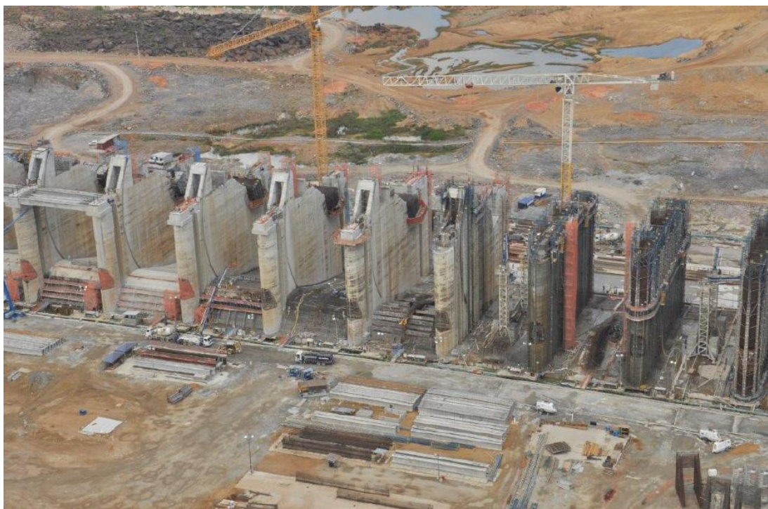
Figura 13: Casa de Força Sítio Pimental.
