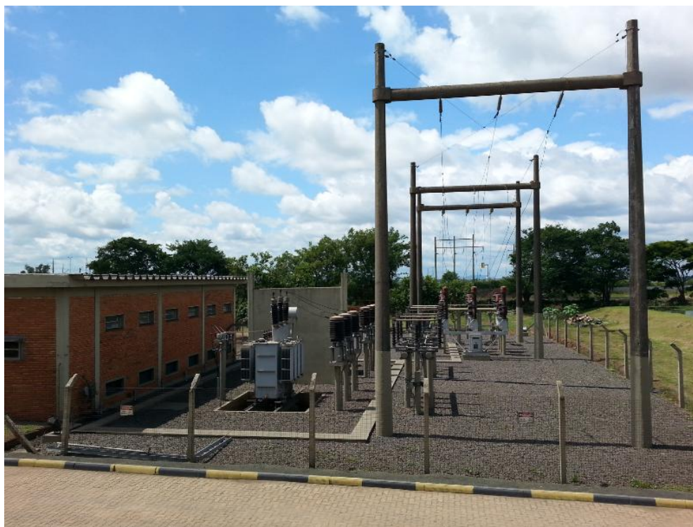
Figura 24: linha de transmissão conectada à subestação da companhia
