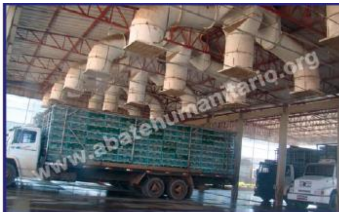
Figura 8 - Exaustor posicionado para remover o calor de dentro das caixas Fonte: Steps – WSPA
