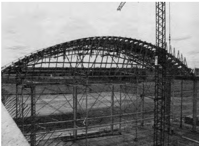
Forma de madeira apoiada sobre escoras metálicas contraventadas de 30 metros de vão, no depósito da Lanas Trinidad em Durazno.
