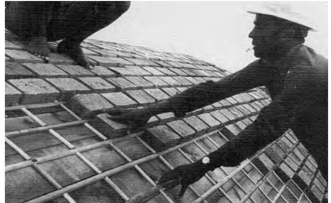
Ripas de madeira pregadas à forma guiam a colocação dos tijolos. Após, barras de aço são colocadas nas juntas, logo preenchidas com concreto.
