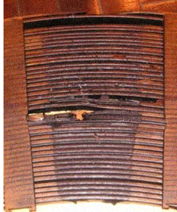
Figura 26 – Curto-circuito entre espiras devido ação de enxofre corrosivo [56]
