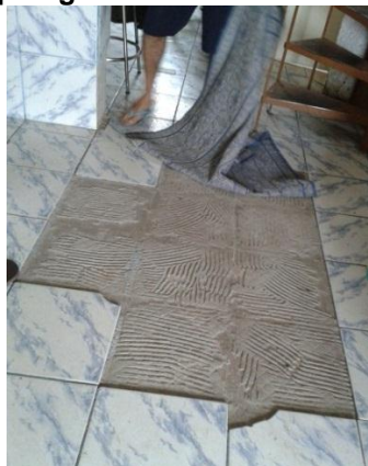
Figura 102 - Rachaduras internas (sala) Fonte: Acervo pessoal (2014)
