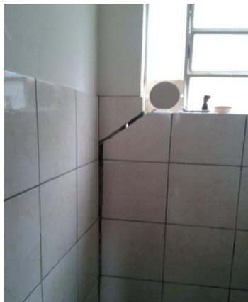
Figura 101 – Rachaduras internas (banheiro) Fonte: Acervo pessoal (2014)
