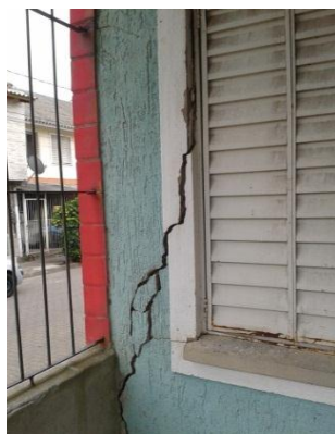
Figura 96 – Rachaduras externas (fachada frontal)
