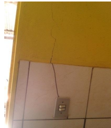
Figura 103 - Rachaduras internas (cozinha) Fonte: Acervo pessoal (2014)
