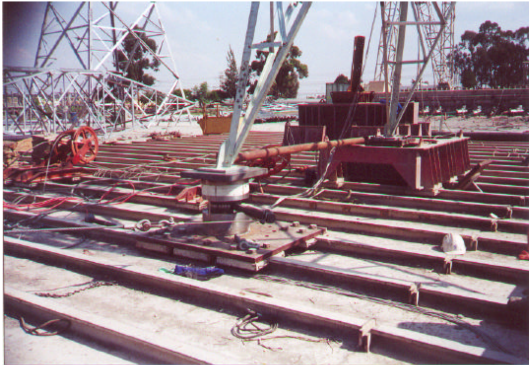
Figura 6.36 – Apoio móvel da torre 2 na estação de testes da ESKOM.
