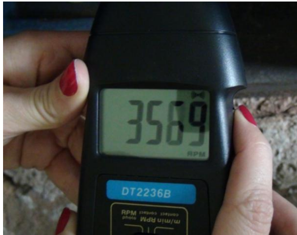
Figura 4.18 - Verificação da rotação de trabalho do conjunto motobomba.
