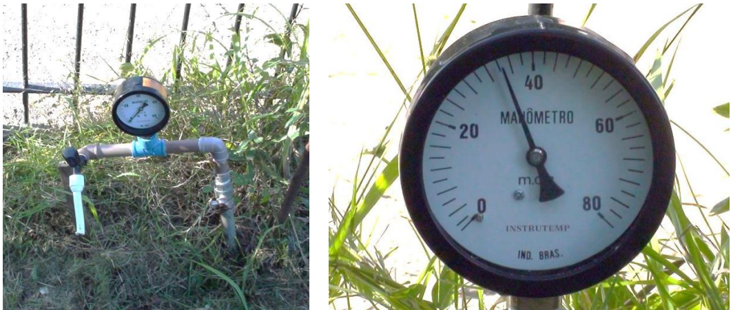
Figura 4.15 - Manômetro inserido em uma derivação da adutora que liga o hidrometro até RI para verificar a pressão com que a água vem do DMAE ate o primeiro reservatório.
