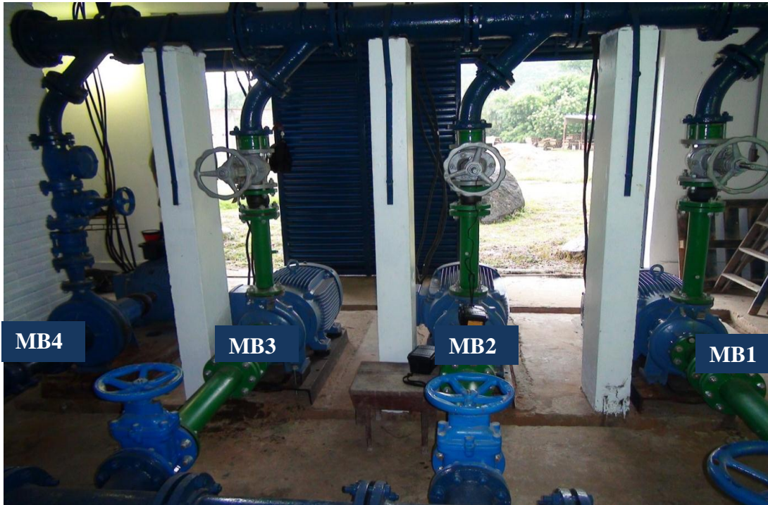
Figura 4.3 - Quatro conjuntos motobomba instalados na casa de maquinas do Campus do Vale da UFRGS.
