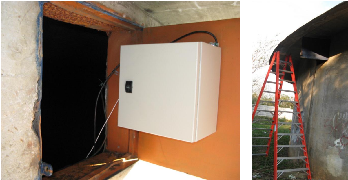
Figura 4.12 - Caixa que contém o medidor de pressão hidrostático, o data logger e as baterias (à esquerda). À direita tampa para inspeção e limpeza do reservatório R1 na qual o caixa com o medidor de nível foi fixada.
