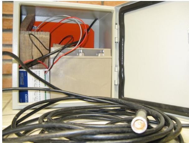
Figura 4.5 - Caixa para a aquisição de nível da água dos reservatórios.
