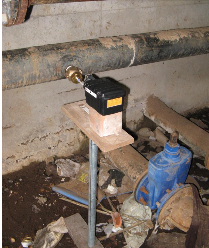
Figura 4.11 - Medidor de pressão instalado na tubulação que abastece o reservatório RII.
