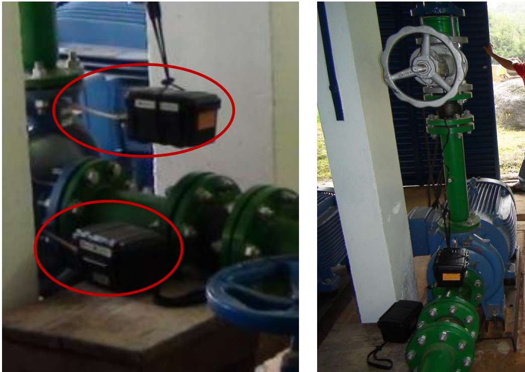
Figura 4.7 - Medidores de pressão instalados na sucção e no recalque das bombas.
