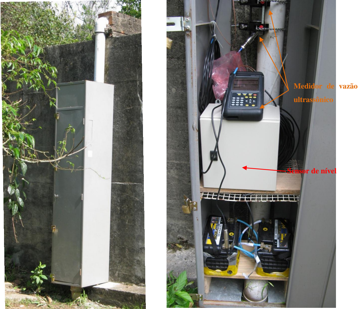
Figura 4.13 - Vista frontal do painel ( à esquerda) e distribuição dos medidores de vazão e nível no interior do painel (à direita).
