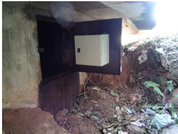
Figura 4.6 - Caixa para a medição de nível fixada na porta de inspeção do reservatório RI.
