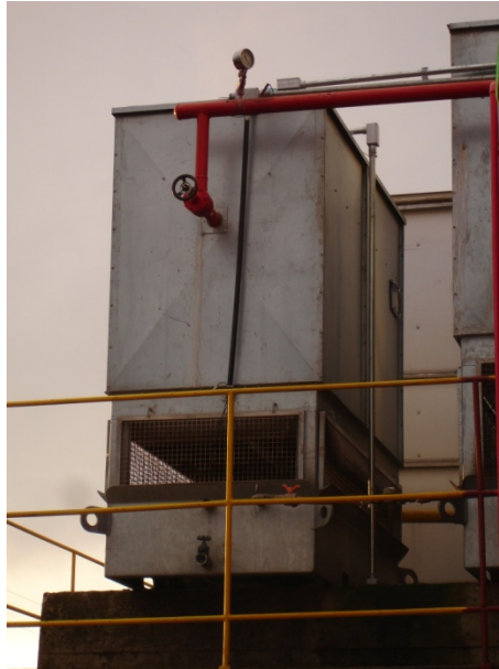
Figura 3.2 - Condensador Evaporativo RC-200.
