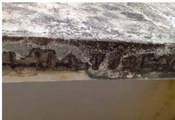
Figura 4 – Corrosão de armadura em uma viga com cobrimento de concreto insuficiente
