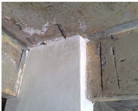
Figura 7 – Laje e vigas apresentando destacamento da camada de cobrimento de concreto, com armaduras expostas
