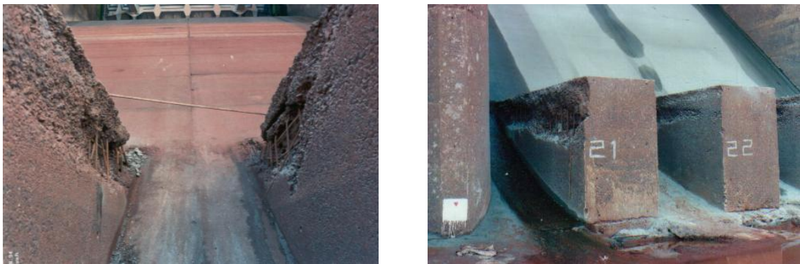
Figura 31: Erosão no pé da barragem de Porto Colômbia, MG, causada por cavitação devido ao descolamento do escoamento em altas velocidades (fonte: ELETROBRAS FURNAS)
