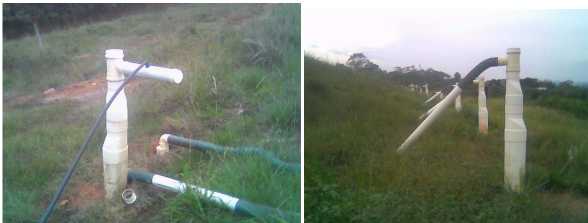
Figura 4.3 – Ponto de captação e pontos de saída de gás no aterro sanitário da Extrema.
