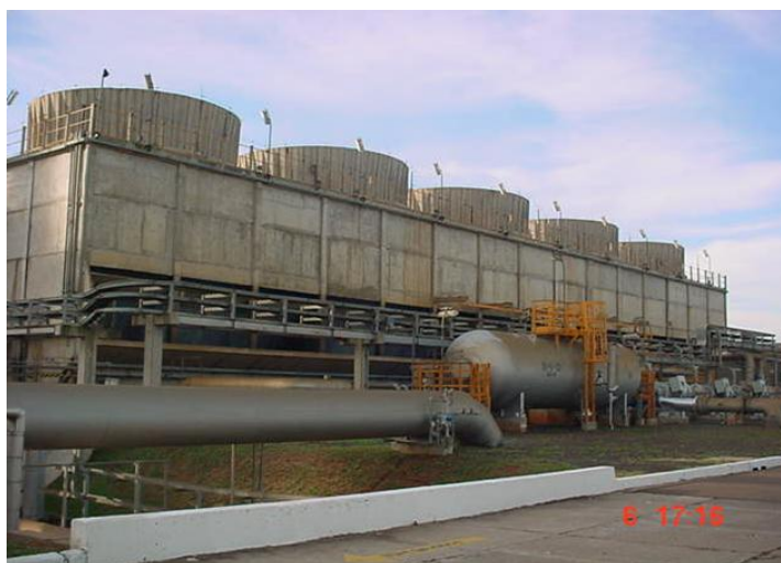
Figura 2.3: Torre de resfriamento localizada na indústria em estudo.
