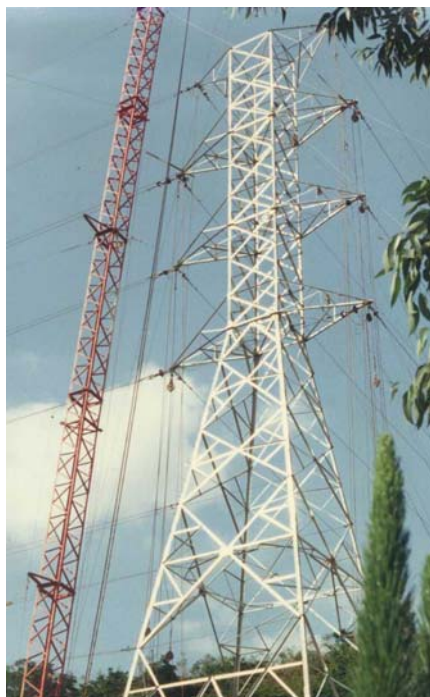
Figura 4.5: Teste de carga em um protótipo de torre de LT de 230 kV, circuito duplo.
