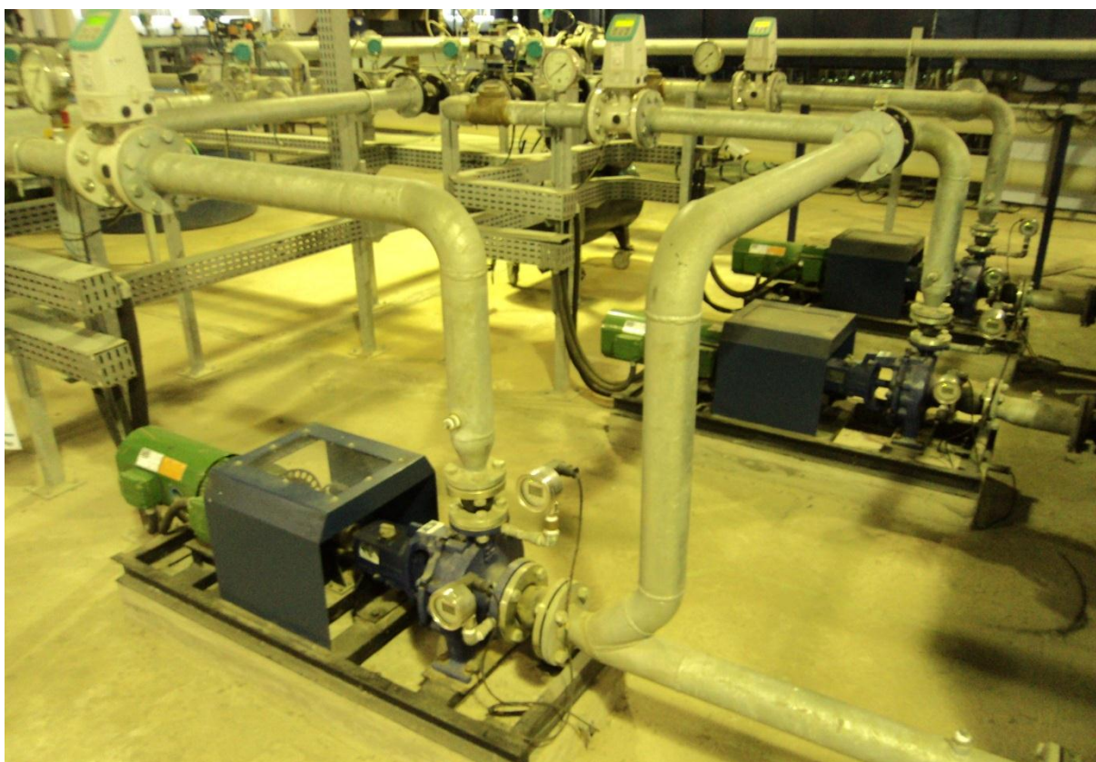
Figura 6 – Estação de recalque do Lenhs
