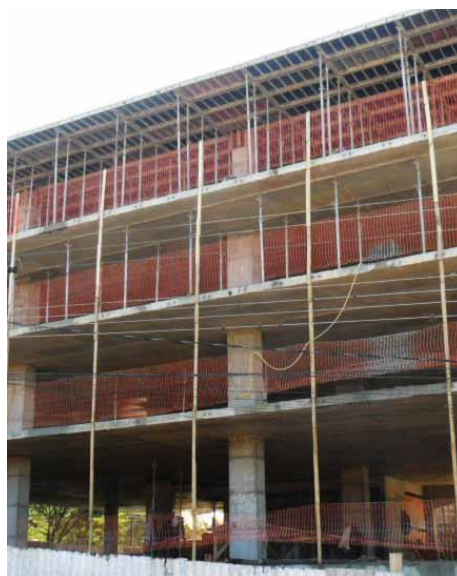
Figura 7 – Sistema modular para fôrmas de lajes
