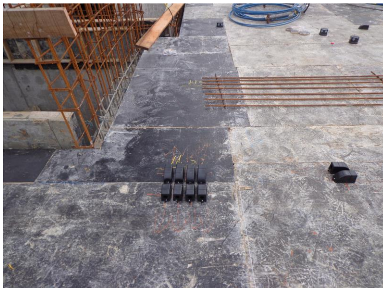
Figura 26 – Caixas de passagem
