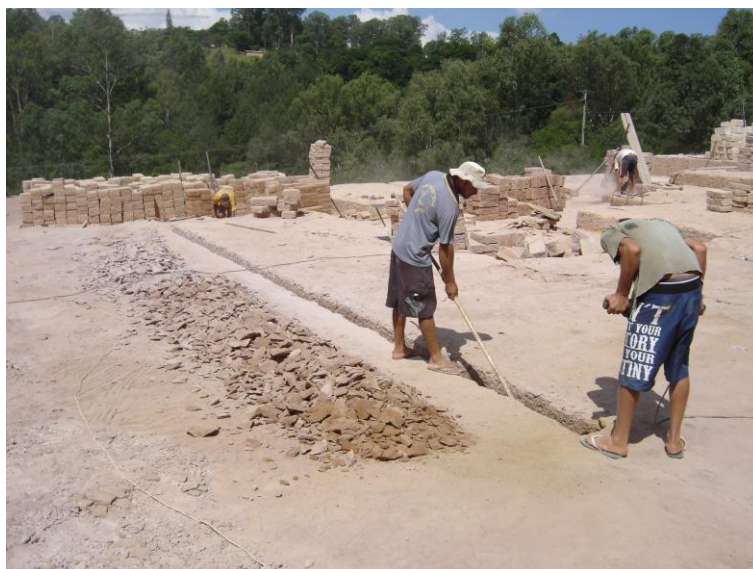
Figura 6 – Abertura de fendas no arenito
