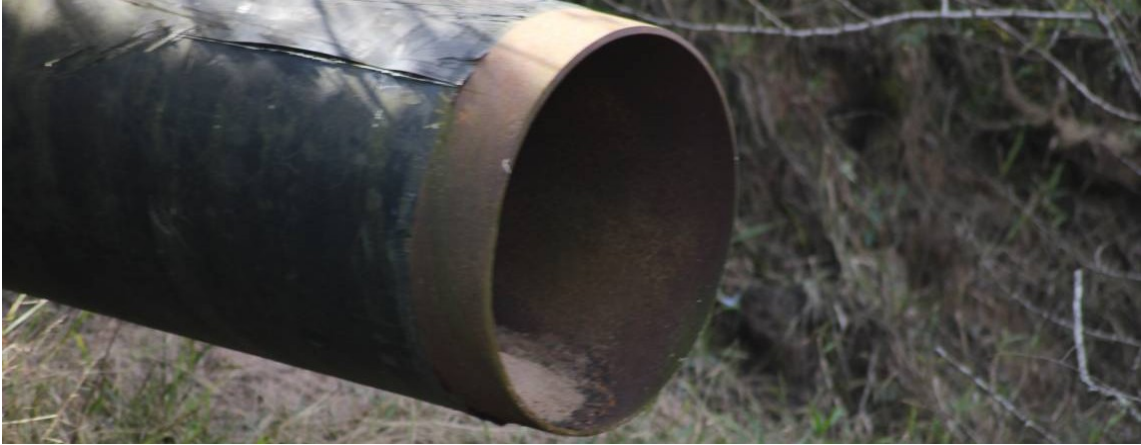
Figura 22. Dutos utilizados no sistema de irrigação da produção orizícola. Foto: Cecilia Balsamo Etchelar. Data da imagem: 15 de Julho de 2013.
