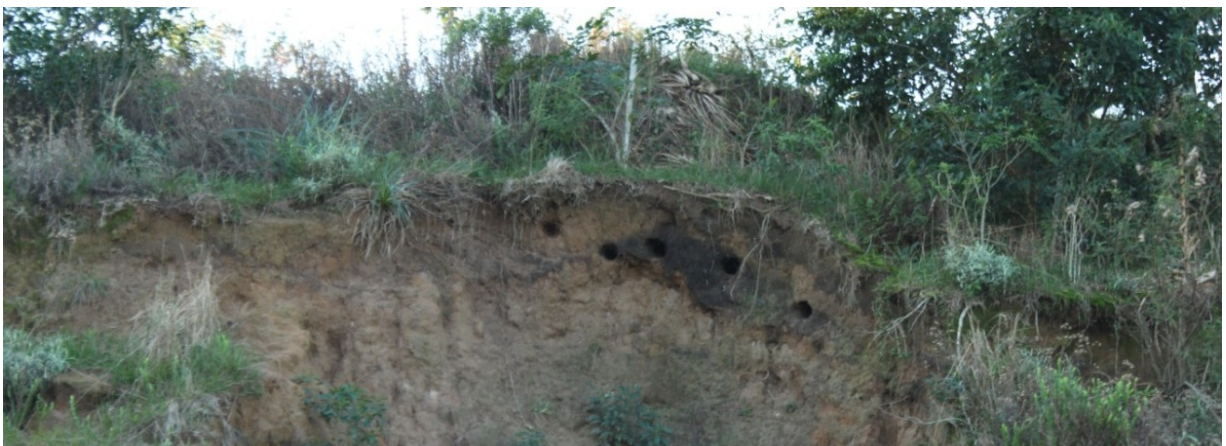
Figura 34. Dutos próximos da área de erosão. foto: Cecilia Balsamo Etchelar. Data: 17 de maio de 2014.
