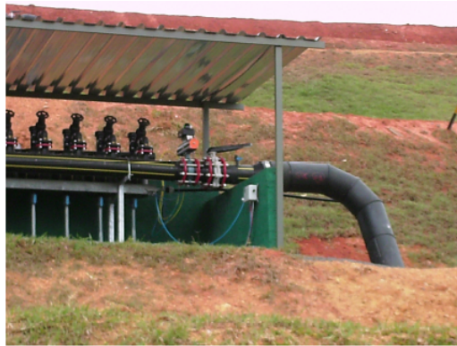
Figura 6 – Tubos de coleta de biogás.
