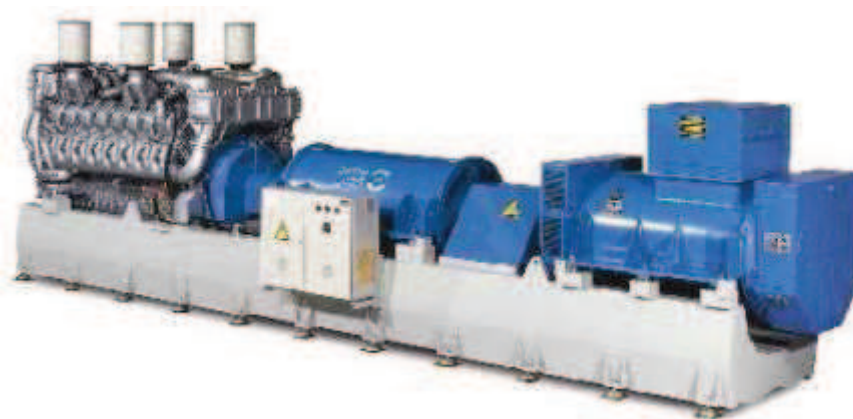
Figura 16 – UPS Dinâmica 625 kVA.
