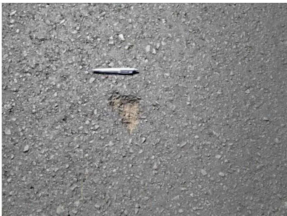
Figura 120. Surgimento de panelas no trecho monitorado I a partir do arrancamento de agregados expostos, após 3 anos de tráfego
