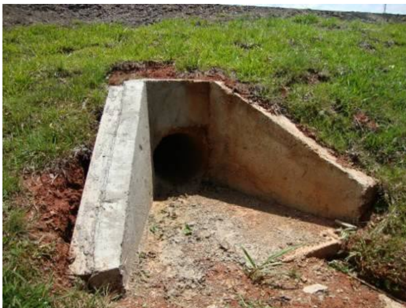
Figura 32. Sistema de drenagem no trecho monitorado – bueiro transversal
