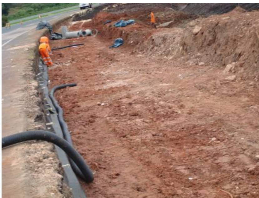
Figura 33. Sistema de drenagem no trecho monitorado – dreno longitudinal
