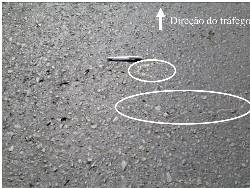
Figura 122. Surgimento de trincas por fadiga no trecho monitorado I
