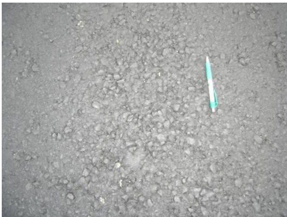
Figura 118. Polimento dos agregados nos trechos monitorados, após 1 ano de tráfego
