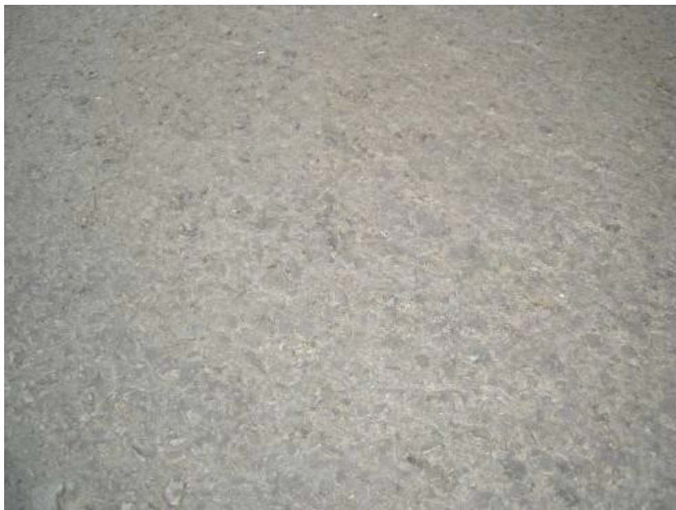
Figura 117. Desgaste superficial no centro da faixa de rolamento nos trechos monitorados, após 6 meses de tráfego
