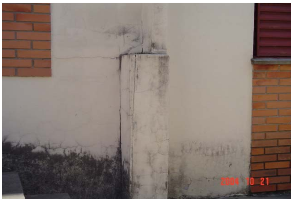
Figura 38: manifestações em revestimento externo no condomínio Dona Eugênia
