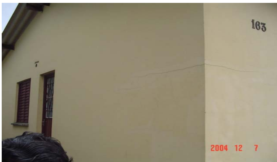
Figura 41: pintura desbotada na região das fissuras em parede do condomínio São Guilherme.
