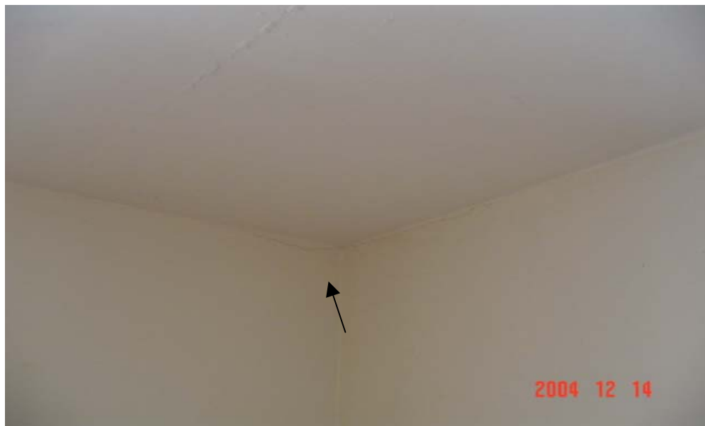
Figura 21: fissura na face interna da parede junto à laje de entrepiso. Condomínio Pôr do Sol.
