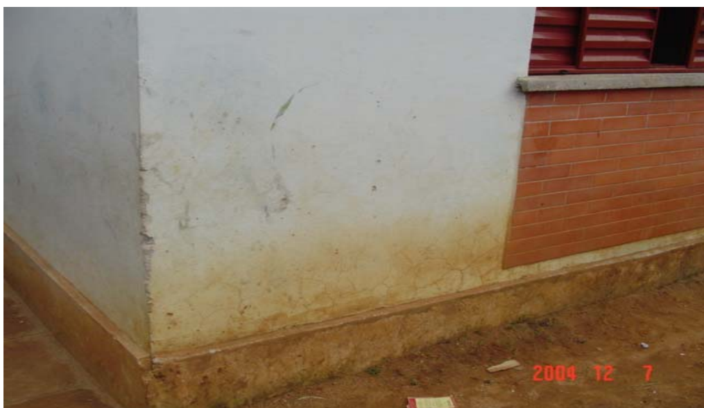
Figura 37: manifestações em revestimento externo no condomínio São Guilherme.
