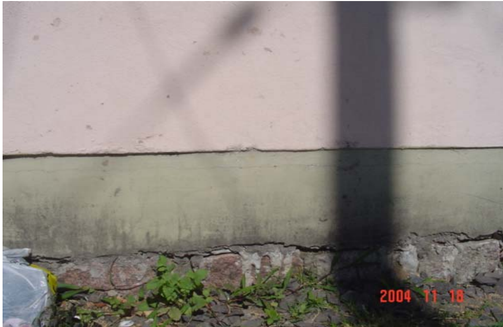
Figura 10: Condomínio Renascer →Alvenaria de pedra + baldrame com fissura + parede
