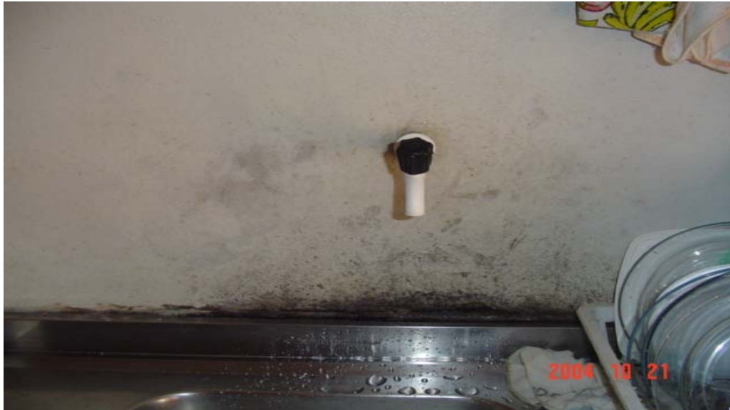
Figura 32: manchamento do revestimento pela presença de umidade (pia de cozinha). Condomínio Dona Eugênia.
