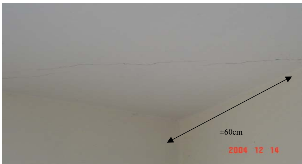
Figura 48: fissura na face inferior de laje de concreto – tipo “c”. Condomínio Pôr do Sol.
