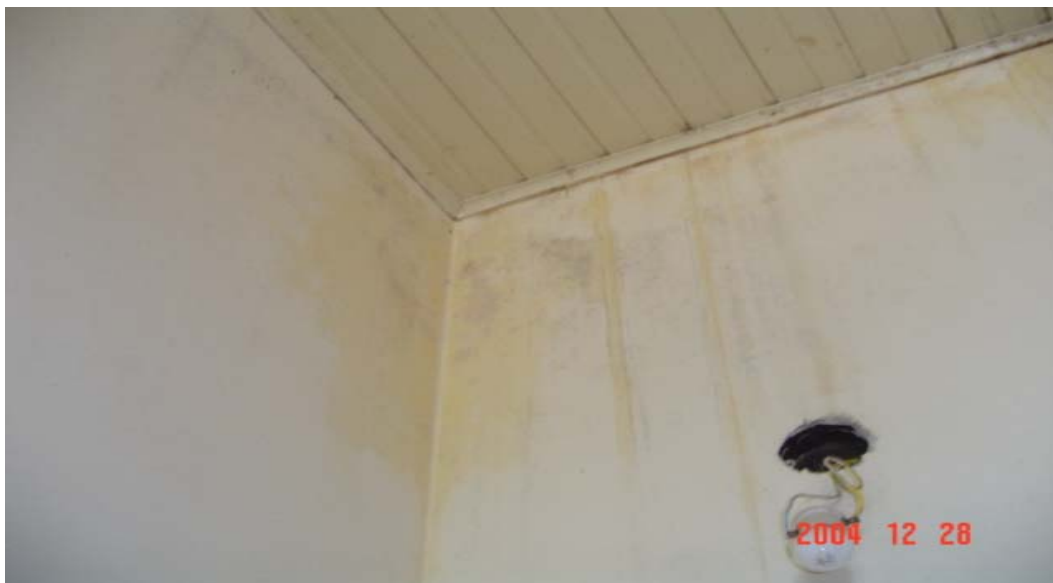
Figura 28: manchamento e presença de umidade por infiltração de água de chuva pelo telhado e pela parede. Condomínio Costa e Silva.
