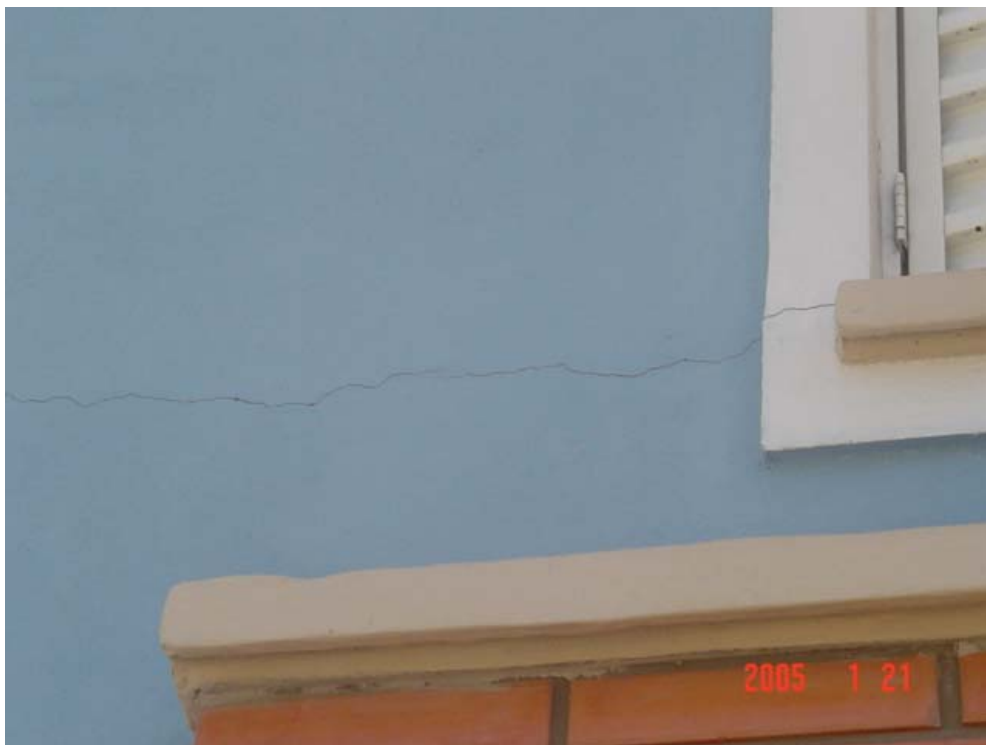
Figura 15: fissuração da parede à partir da janela. Condomínio Pôr do Sol.
