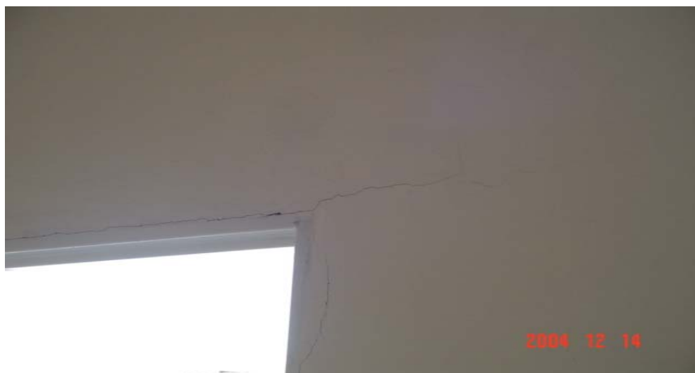
Figura 23: fissuras junto à porta na face interna da parede. Condomínio Pôr do Sol
