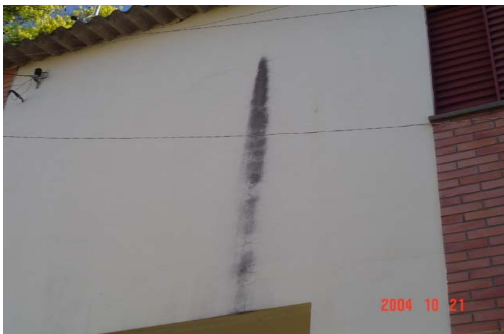
Figura 39: manifestações em revestimento externo no condomínio Dona Eugênia
