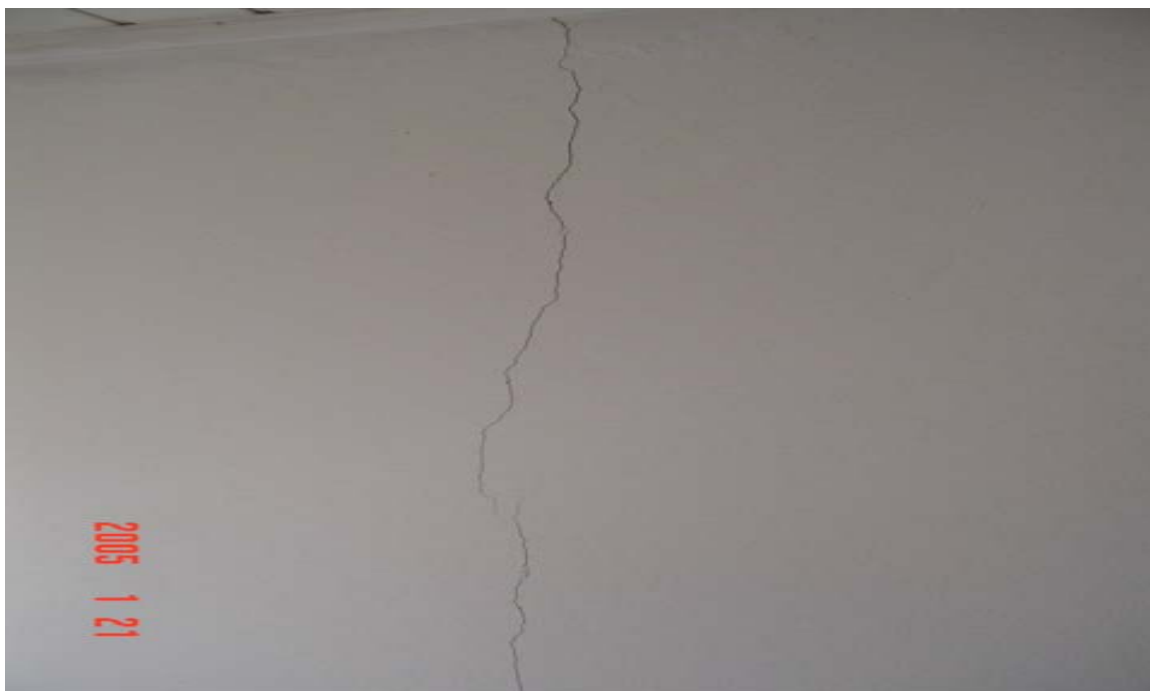
Figura 24: fissura vertical em parede do segundo pavimento. Condomínio Pôr do Sol.
