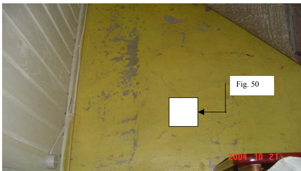
Figura 49: fissura no piso do 2º pavimento (laje de entrepiso) no condomínio Dona Eugênia.
