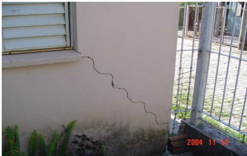
Figura 63 – Fissura característica de recalque diferencial. Cond. Renascer.
