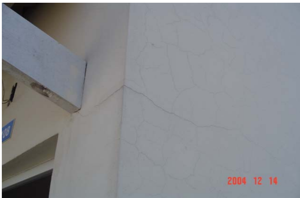
Figura 36: fissuração do revestimento externo em mapeamento. Parede Su-Sudoeste no condomínio Pôr do Sol
