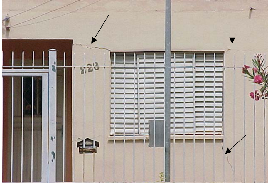
Figura 2 – Fissuras em parede junto à janela
