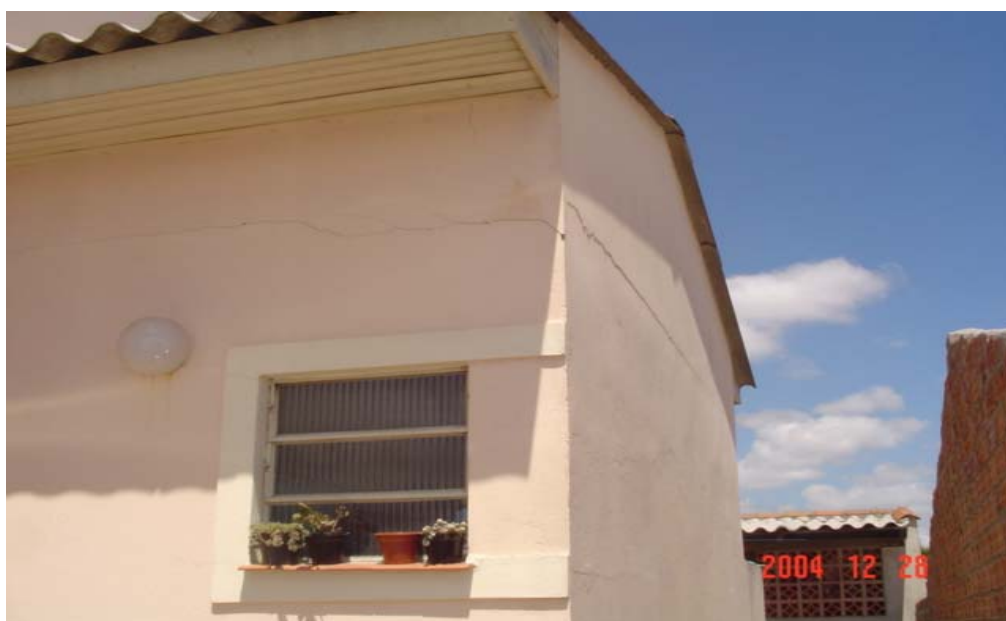
Figura 59 – Fissuração junto à laje no condomínio Costa e Silva
