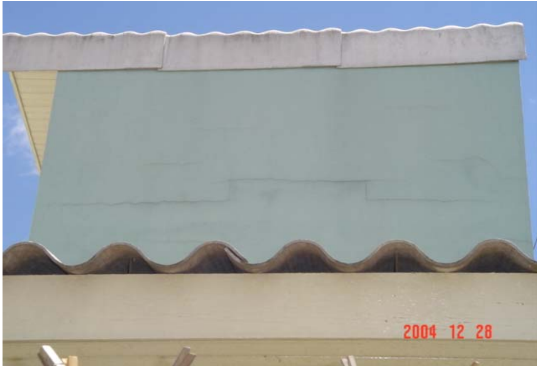
Figura 26: fissuração da face externa que permitiu a passagem de umidade para a face interna da parede. Condomínio Costa e Silva
