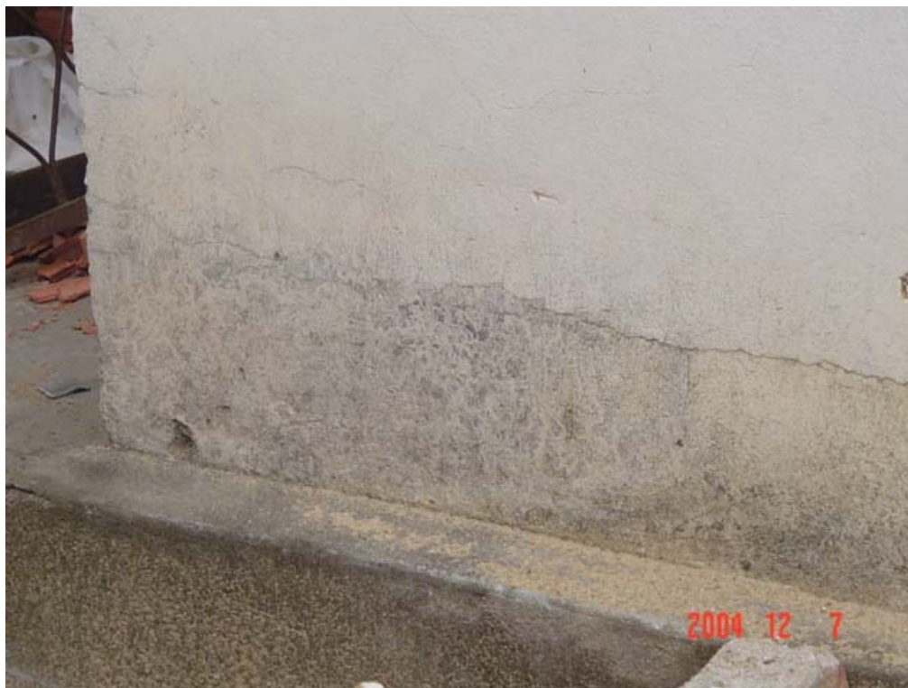
Figura 17: umidade ascendente provocando fissuração na parede. Condomínio São Guilherme.
