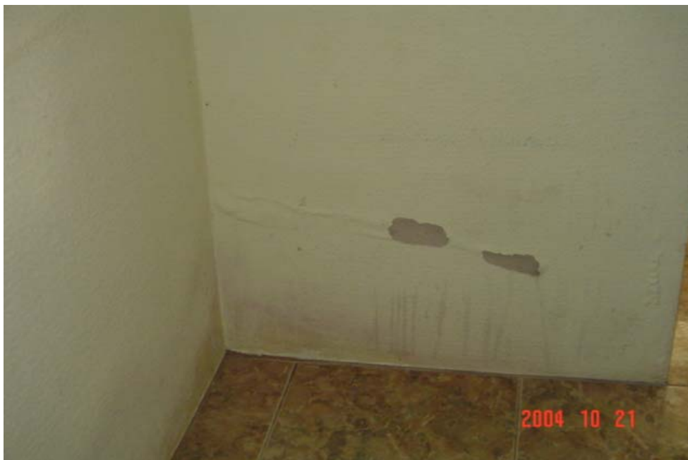
Figura 31: rompimento da pintura e esfarelamento do reboco. Condomínio Dona Eugênia
