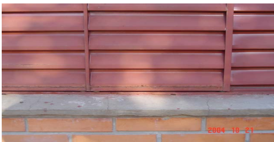
Figura 54: corrosão em janela de ferro. Condomínio Dona Eugênia
