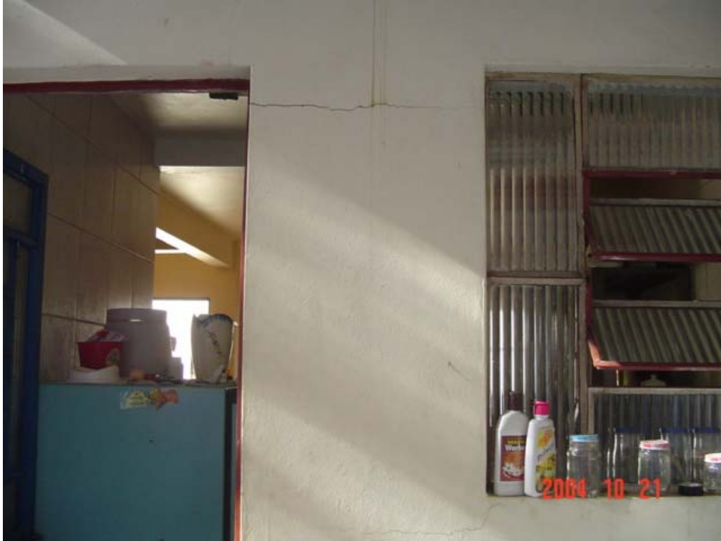
Figura 18: fissuração junto à porta e janela da cozinha. Condomínio Dona Eugênia.
