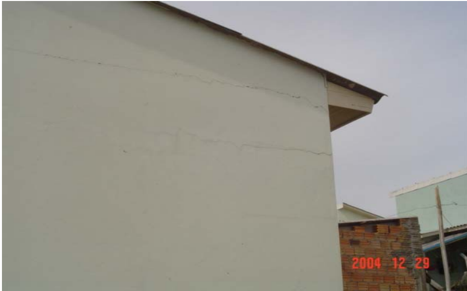
Figura 14: fissuração da parede junto à laje. Condomínio Costa e Silva.
