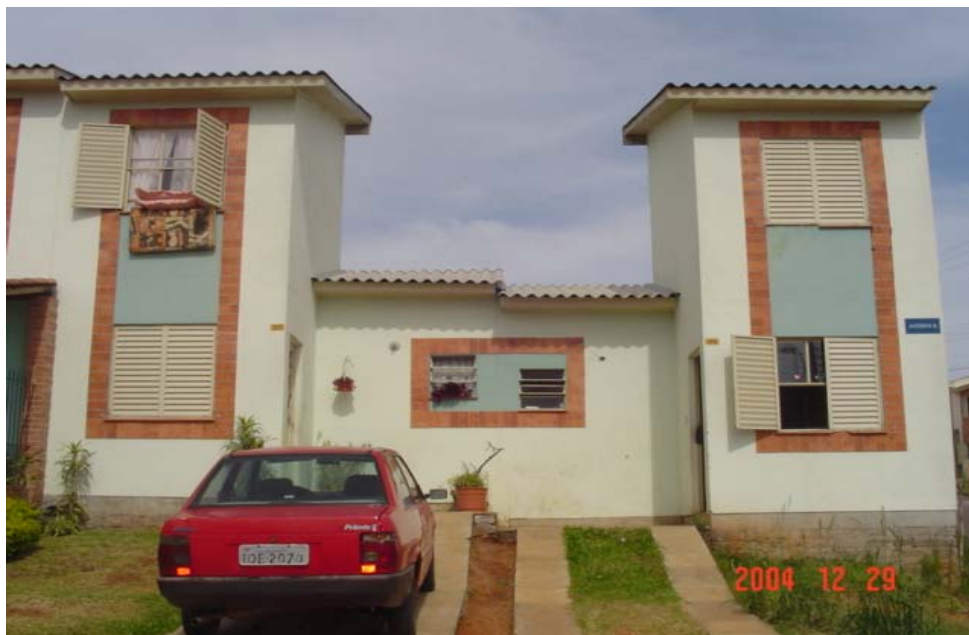
Figura 42: estado geral da pintura externa de unidade habitacional construída em 2001. Condomínio Costa e Silva.
