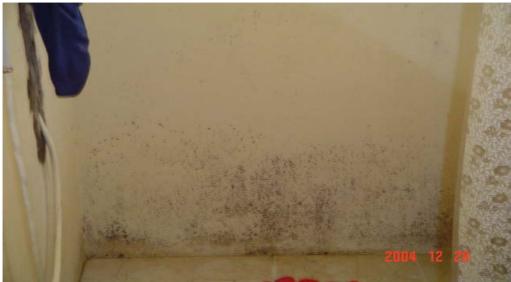
Figura 33: manchamento do revestimento pela presença de umidade (box de banheiro). Condomínio Renascer.
