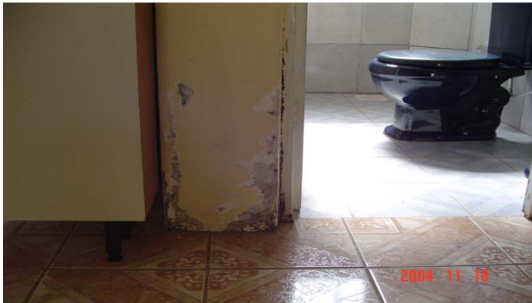
Figura 27: base da parede manchada e com o revestimento deteriorado pela presença de umidade ascensional. Condomínio Renascer.
