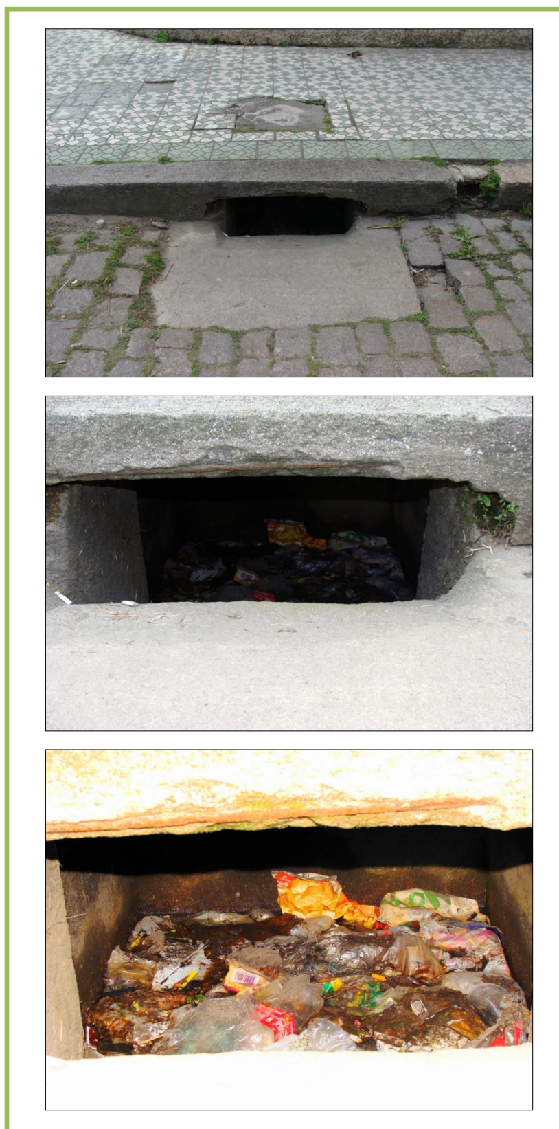
Figura 18 - Condição de “entupimento” de uma “Boca de Lobo” pela presença de Resíduos Sólidos (03/10/2011, Rio Grande/RS). Registradas pelo Autor.
